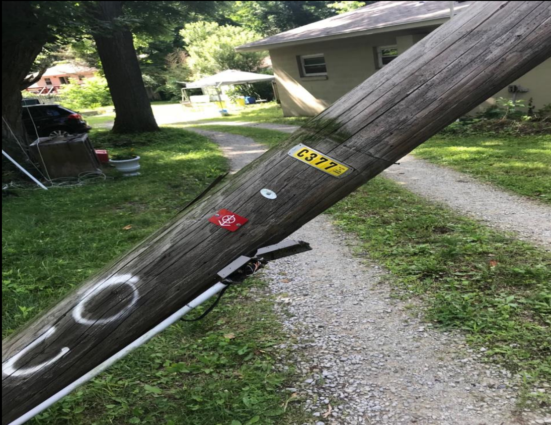
Pole Inspection Red Tags
